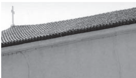
Εικ. 7. Βύθιση του «κορφιά» της στέγης.
