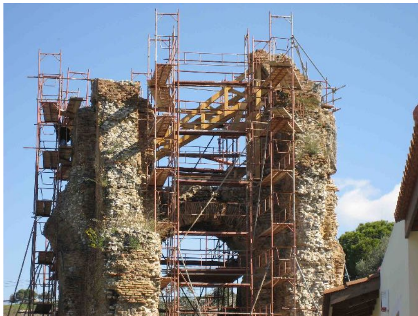
Εικ. 6. Ξύλινο δικτύωμα της αντιστήριξης της απόληξης του εναπομείναντος τμήματος άνω τόξου (φωτ. Μ. Μεντζίνη).
