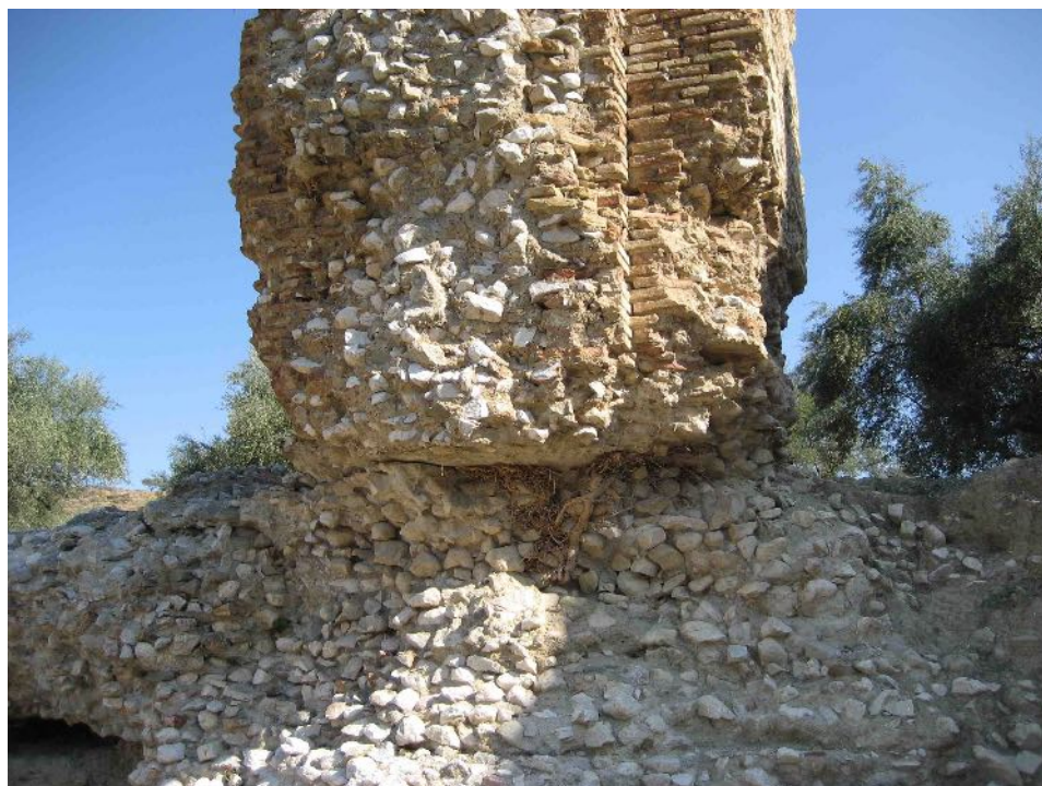
Εικ. 2. Απομείωση μάζας στον πόδα πεσσού. Εμφανής η δομή της τοιχοποιίας του μνημείου (φωτ. Μ. Μεντζίνη).
