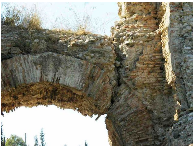
Εικ. 2. Ο τρόπος κατασκευής της οπτοπλινθοδομής και τυπική αστοχία στην περιοχή πλοκής πεσσού και τόξου (φωτ. Μ. Μεντζίνη, Αρχείο ΕΦΑΑΧΑ).
