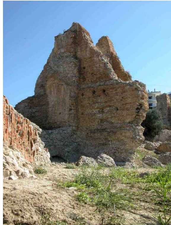
Εικ. 4. Αποσπασμένοι συμπαγείς όγκοι από την ανωδομή του υδραγωγείου (φωτ. Μ. Μεντζίνη, Αρχείο ΕΦΑΑΧΑ).
