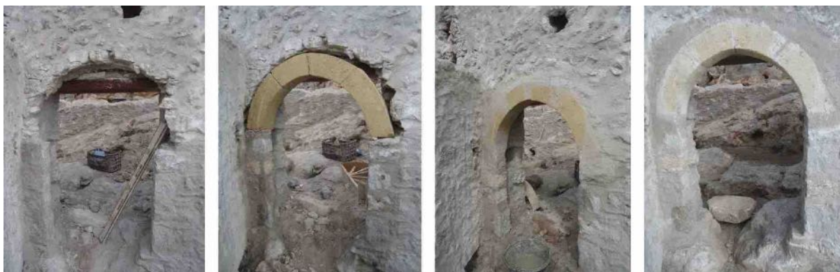
Εικ. 8. Κάστρο Γερακίου, οικισμός. Κτήριο 9, κτίσμα Α, δυτικός τοίχος. Εξωτερική όψη, συμπλήρωση θυραίου ανοίγματος (φωτ. Α. Μαρδά-Στυψιανού, Αρχείο ΕΦΑΛΛΑΚ).
