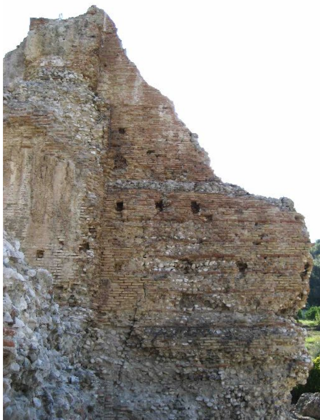
Εικ. 3. Κατακόρυφη ρωγμή, που εκτείνεται καθ' ύψος της αντηρίδας (φωτ. Μ. Μεντζίνη).
