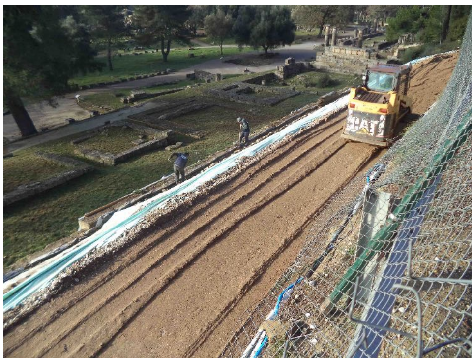
Εικ. 6. Αρχαιολογικός Χώρος Ολυμπίας: εργασίες σταθεροποίησης του πρανούς του Κρονίου Λόφου με την κατασκευή συστοιχίας μικροπασάλων στο πλαίσιο του έργου «Προστασία και ανάδειξη του Ιερού της Δήμητρας Χαμύνης και του αναλήμματος των Θησαυρών του Κρονίου Λόφου στην Αρχαία Ολυμπία», άποψη από ΝΔ (Αρχειο ΕΦΑΗΛ).
