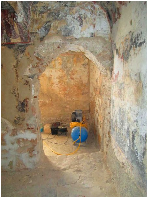
Εικ. 1. Άγιος Νικόλαος Οχιάς. Τοξωτό άνοιγμα επικοινωνίας μεταξύ ΒΔ γωνιακού διαμερίσματος και βόρειου τμήματος νάρθηκα, κατά τη διάρκεια των εργασιών (φωτ. ΕΦΑΛΛΑΚ).
