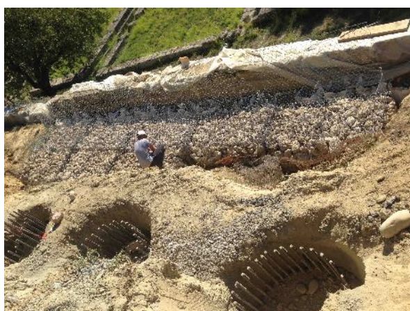
Εικ. 2. Κρόνιος λόφος, εργασίες διάνοιξης συστοιχίας πασάλων και τοποθέτησης συρματοκιβωτίων (Αρχείο ΔΑΑΜ).
