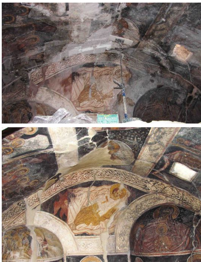
Εικ. 6. Το άνω τμήμα του ανατολικού μετώπου στο ιερό βήμα με την παράσταση του Χριστού Αναπεσόντος κατά τη διάρκεια των εργασιών στερέωσης και μετά τη συντήρηση των τοιχογραφιών.
