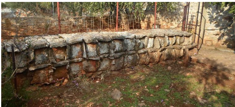
Εικ. 10. Τμήμα λιθόκτιστου μελισσοκομείου στον Πύργο Διρού. Πρόσθια όψη (φωτ. Γ. Μαυροφρύδης).
