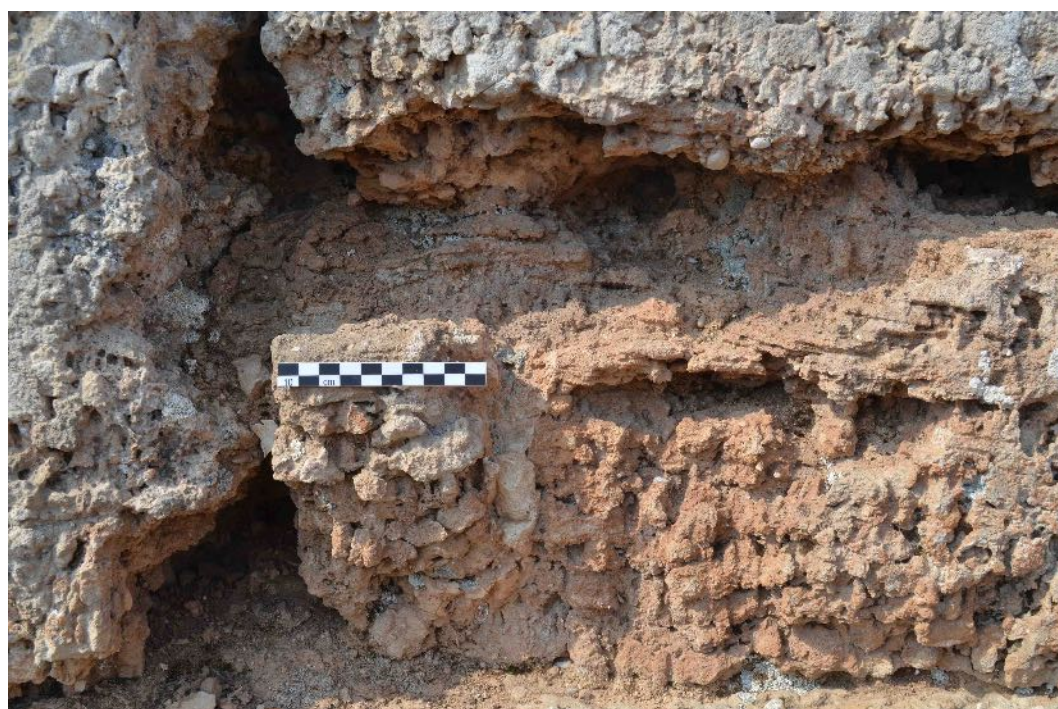
Εικ. 3. Κατάσταση διατήρησης του υλικού δόμησης (λεπτομέρεια) (φωτ. ΕΦΑΚΟΡ).
