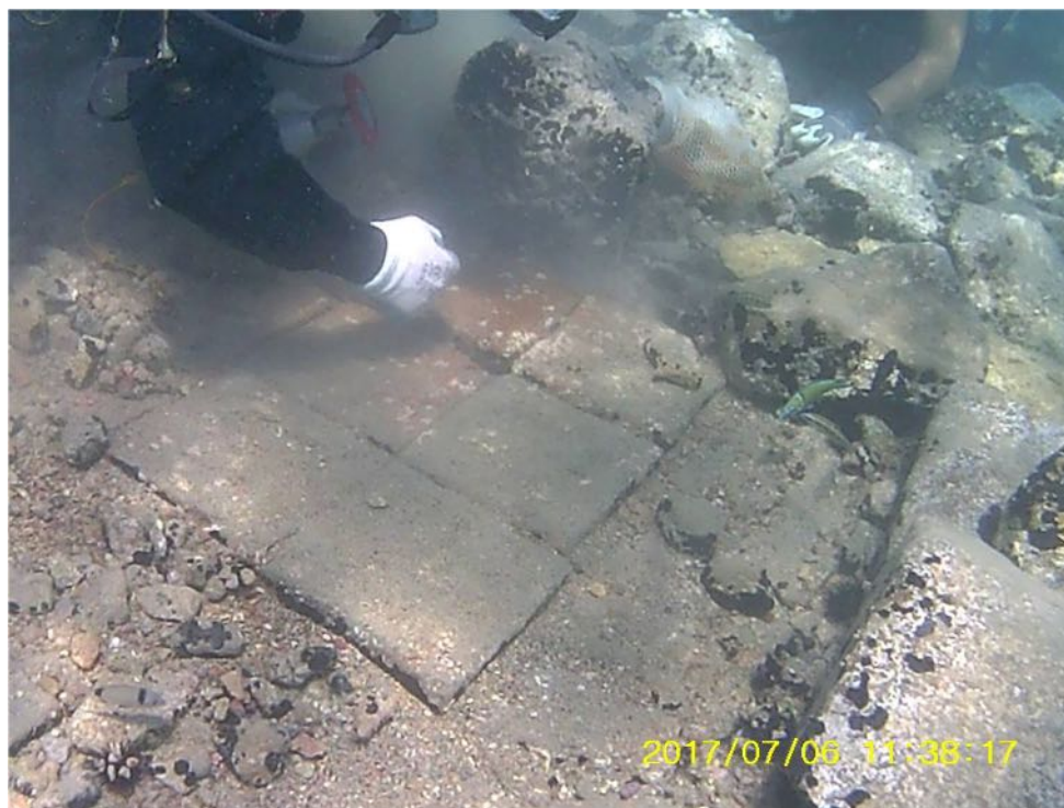
Εικ. 6. Εργασίες συντήρησης σε δάπεδο της ρωμαϊκής έπαυλης στο πλαίσιο του εκπαιδευτικού προγράμματος του 2017 (φωτ. Παναγιώτα Γαλιατσάτου).
