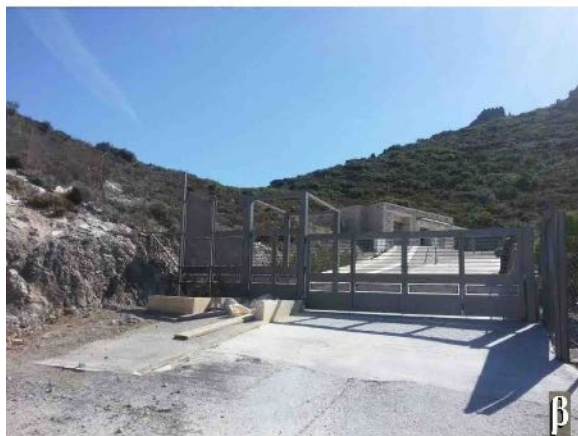
Εικ. 3. Κάστρο Γερακίου, είσοδος αρχαιολογικού χώρου. α) Πριν τις εργασίες. β) Μετά τις εργασίες (φωτ. α: Ε. Ελευθερίου, β: Κ. Ντουβή, Αρχείο ΕΦΑΛΛΑΚ).
